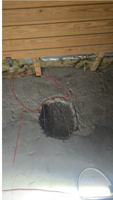
13 - Sauna. Kuivakaivo poistettu. Kosteuspoikkeama alue merkitty punaisella lattiaan noin 0,5m 2 - Petteri Hujanen - 11.04.2026
