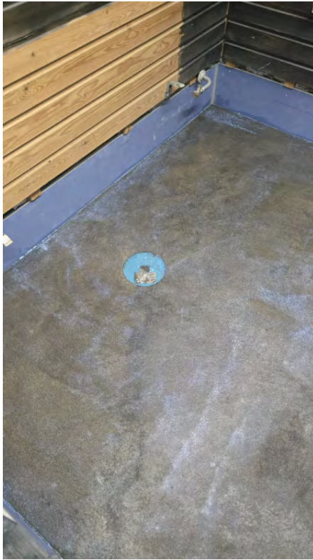
27 - Saunan lattian tasoitettu pinta ennen vedeneristystä. Kaivoalue ja seinäliittymät valmisteltu seuraavaa työvaihetta varten. - Petteri Hujanen - 17.04.2026
