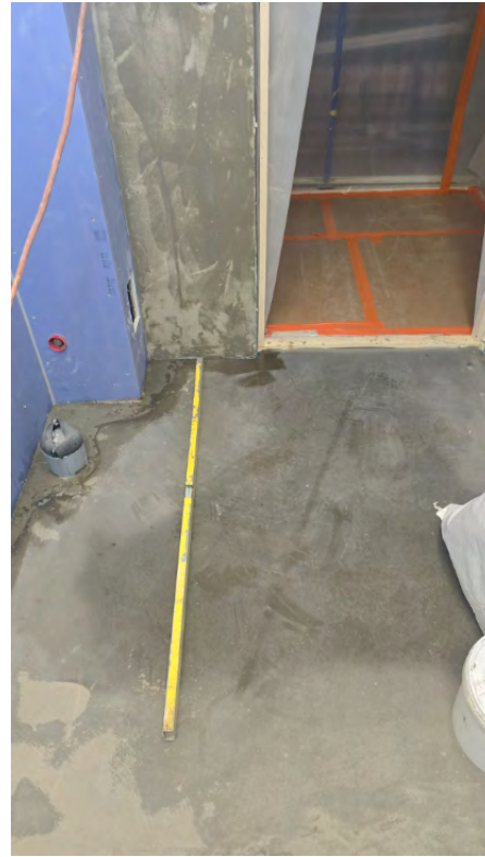
28 - Pesuhuoneen lattian tasoitus ja kaatojen tarkastus. Paikalliset korjaukset viimeistellään ennen vedeneristystöitä. - Petteri Hujanen - 17.04.2026
