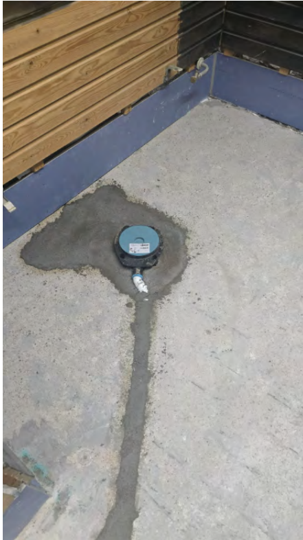
17 - Saunan kuivakaivo ja yhdysputki asennettu. Asennus valmisteltu lattiarakenteen korjausta ja kaatojen tekemistä varten. - Petteri Hujanen - 16.04.2026
