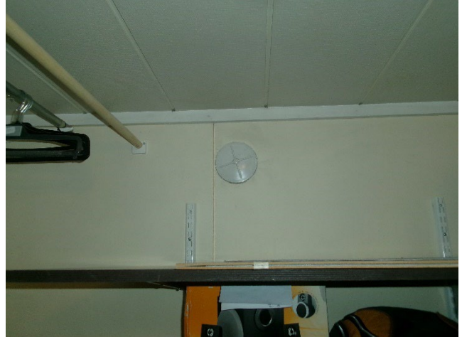
Kuva 44. Painovoimainen ilmanvaihtoventtiili (poistoilma) vaatehuoneen ulkoseinällä
