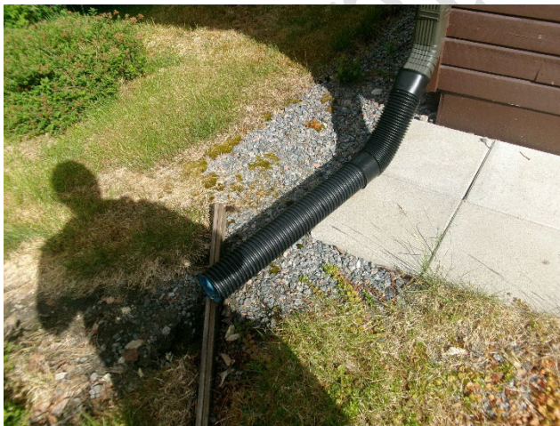
Kuva 3: Sadevedet johdettu syöksytorvelta kauemmas rakennuksesta pintaan asennetulla putkella
