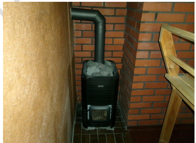
Kuva 20. Löylyhuoneessa puulämmitteinen kivas
