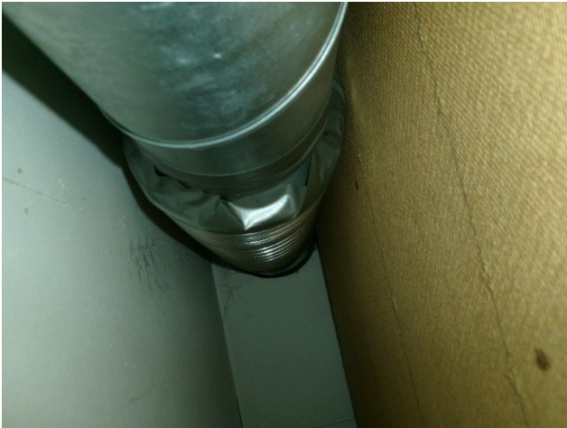
Kuva. 43 Liesituulettimen poistoputki alaosassa teräksistä kierresaumakanavaa, josta jatkuu alumiinisenä haitariputkena
