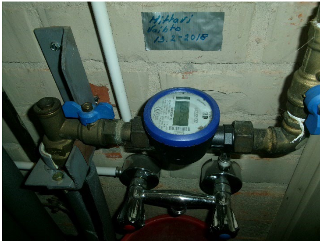
Kuva 41. Vesimittari teknisessä tilassa
