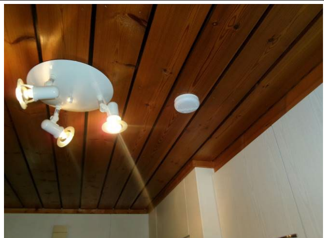
Kuva 46. Palovaroitin asuintilojen alakatossa
