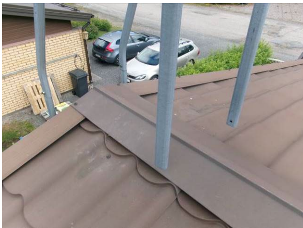
Kuva 13. Talotikkaiden yläjohteita ei ollut tuettu / kannakoitu
