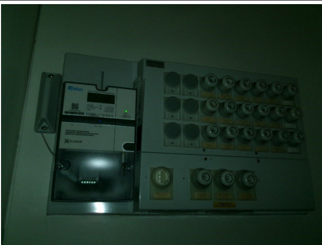
Kuva 45. Sulaketaulu ja sähkömittari tuulikaapissa
