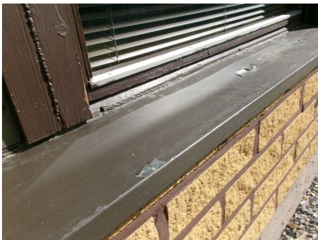
Kuva 9: Ikkunapeltien maalipinnat osin kuluneet
