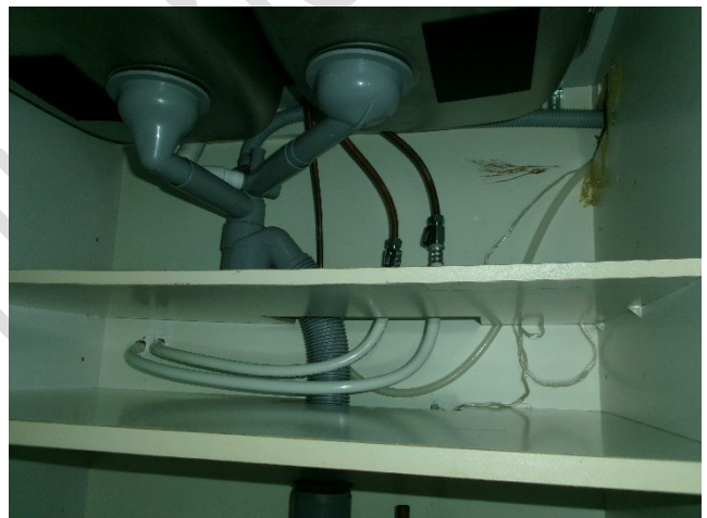
Kuva 28. Allaskaapin putkia ei ollut kannakoitu
